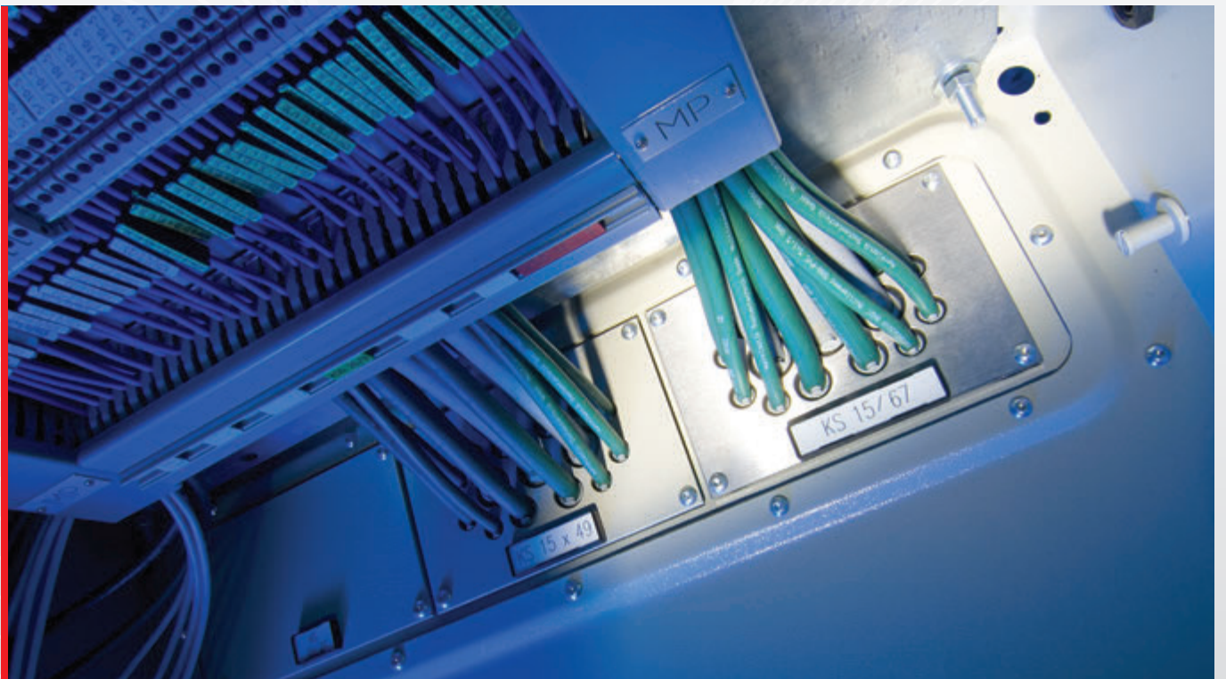
KDP 105/15 в распределительном шкафу
